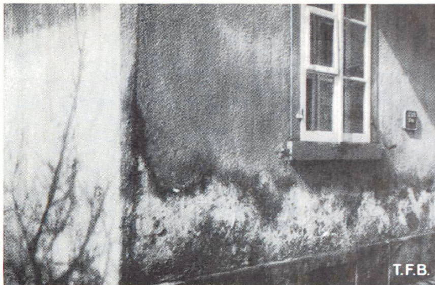
Fig. 4 Colorations et efflorescences imputables à un manque d'isolation horizontale
