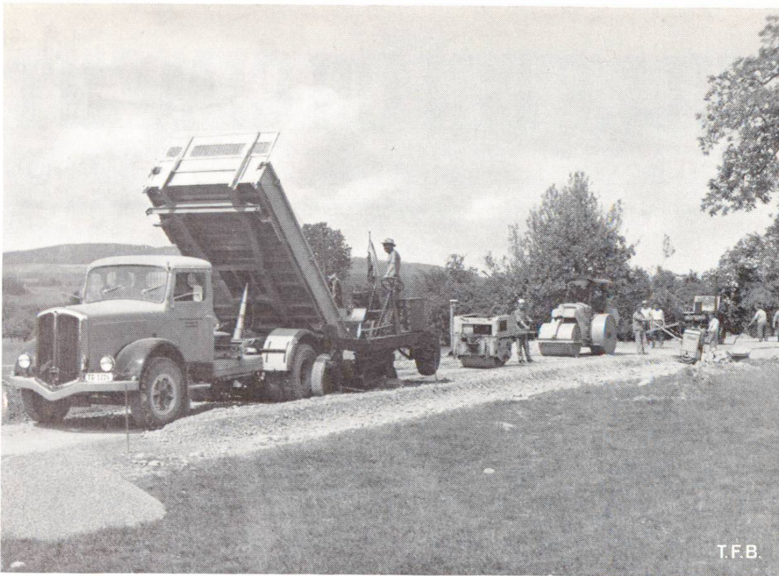
Fig. 1 Construction d'un chemin avec matériaux stabilisés selon le procédé mix in plant. On reconnaît au premier plan l'arrivée des matériaux préparés en centrale et le remplissage de l'engin répandeur. Derrière, les rouleaux, puis le giclage de la pellicule d'émulsion bitumineuse.
