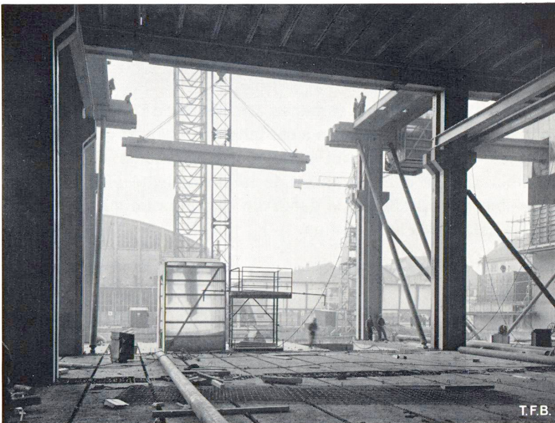
Fig. 6 Mise en place d'une poutre sur les consoles des piliers. Le montage se faisant à partir du sol de la cave, la hauteur maximum de levage fut de 34 m.
