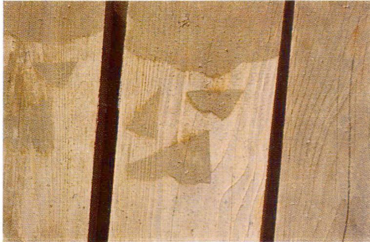
Fig. 4 Les planches après décoffrage. Dans les zones d'altération, une couche de ciment non durci y adhère encore.
