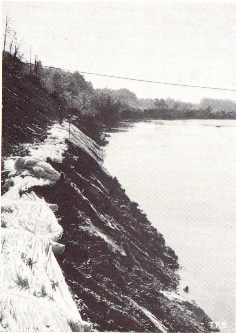
Fig. 7 Toiles de nylon froncées sur la berme. On voit très bien la raideur du talus ( > 1:1 ) ainsi que la grande irrégularité de la surface.
