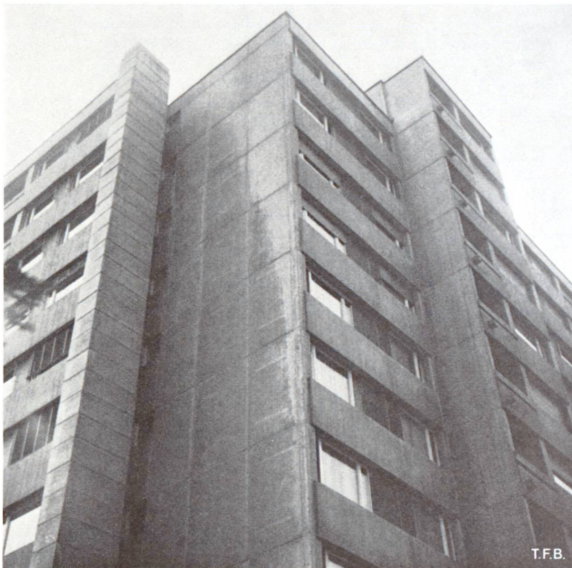
Fig. 2 Revêtement de façade ayant subi l'influence visible de la pluie battante.
