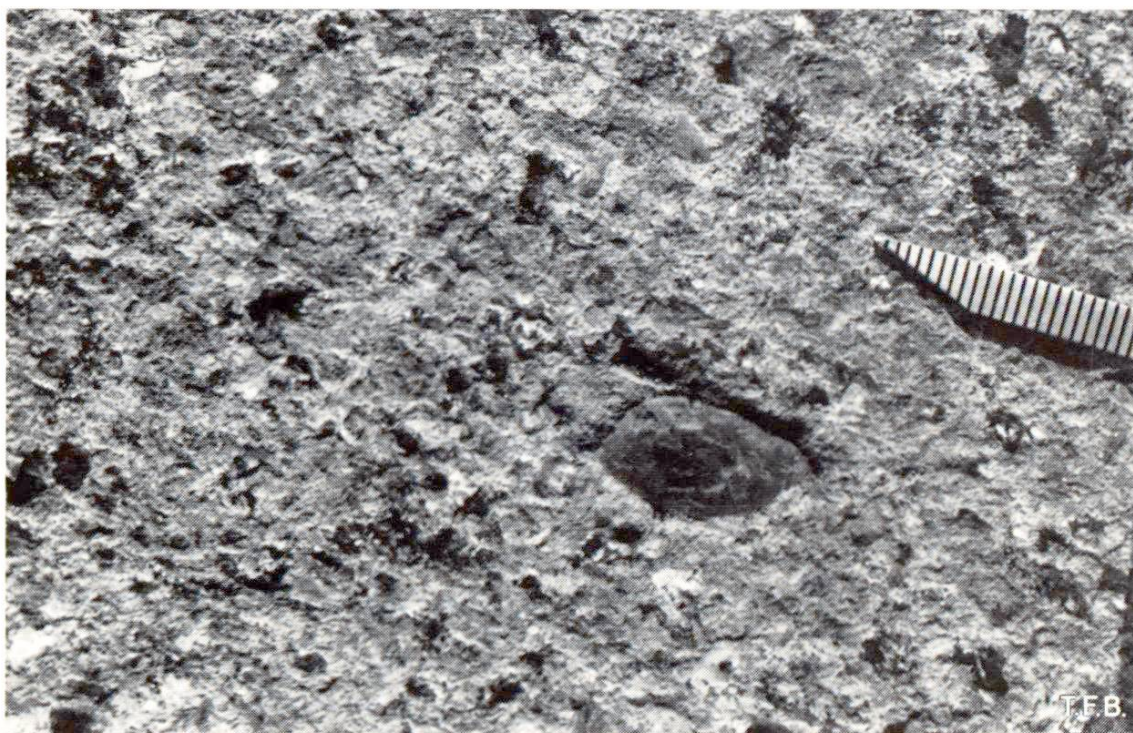
Fig. 8 Etat d'une surface de béton après élimination complète du dépôt de caoutchouc et léger ravivage de la rugosité. Le béton lui-même n'est pas attaqué d'une façon pouvant nuire à l'intégrité du revêtement ou à la forme de la structure de sa surface.
