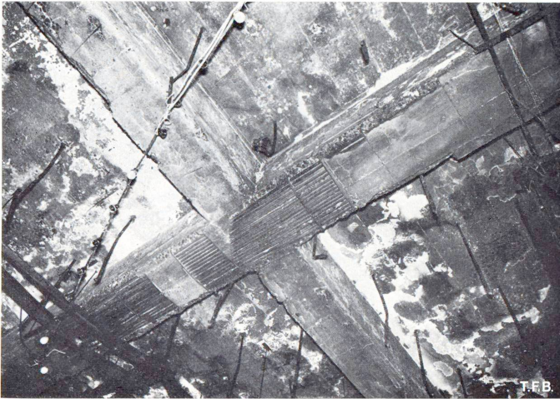
Fig. 3 Détail d'un sommier. La dilatation de l'armature métallique peu profonde a fait éclater la surface du béton.
