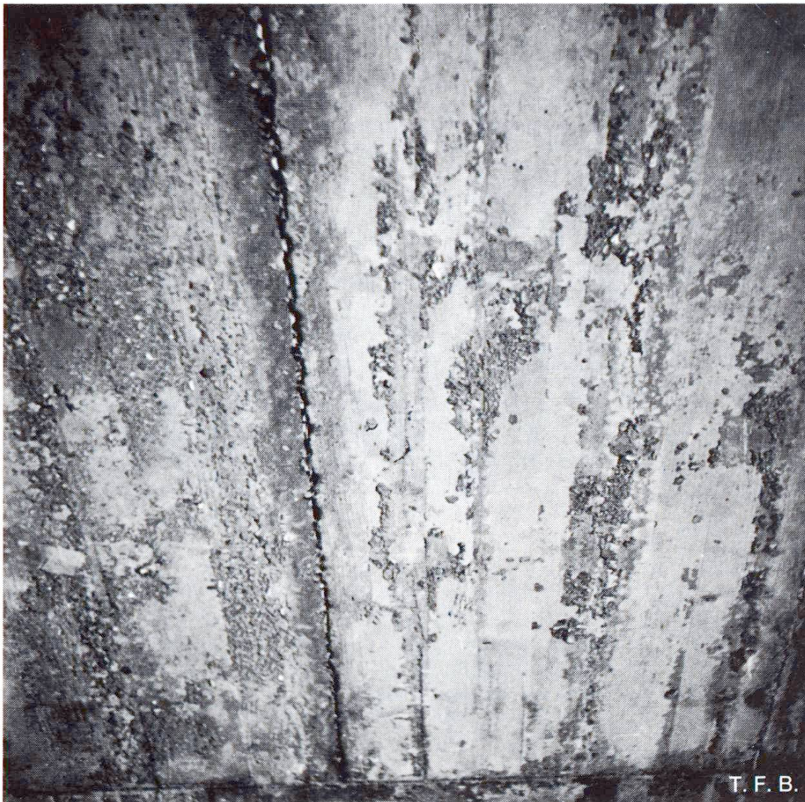
Fig. 5 Un béton à faible teneur en ciment est enclin au ressuage ce qui provoquera des détériorations de la surface.
