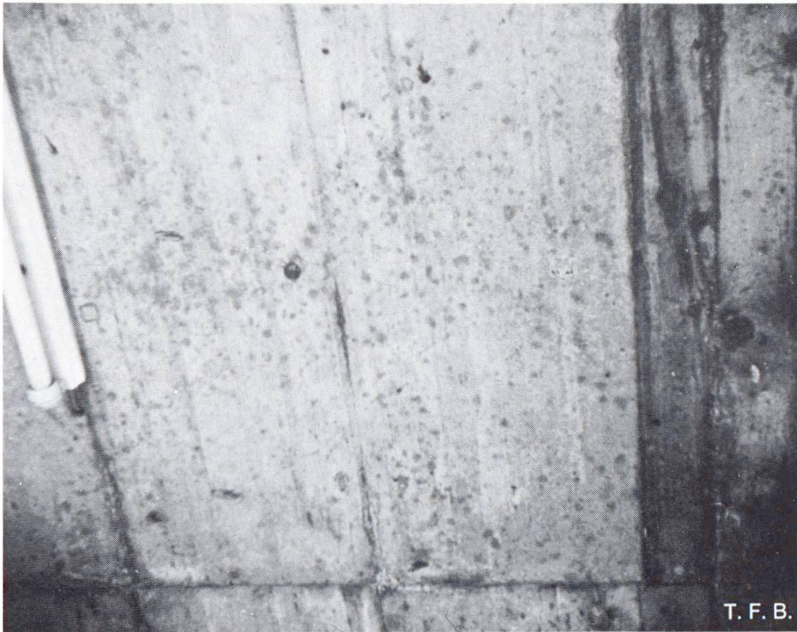
Fig. 4 Dans un béton trop fluide, les gros éléments se sont enfoncés et il s'est produit une séparation entre l'eau et le ciment à la surface du coffrage. Les gros granulats se manifestent par des points foncés dont la répartition irrégulière est due à une vibration irrégulière, elle aussi.
