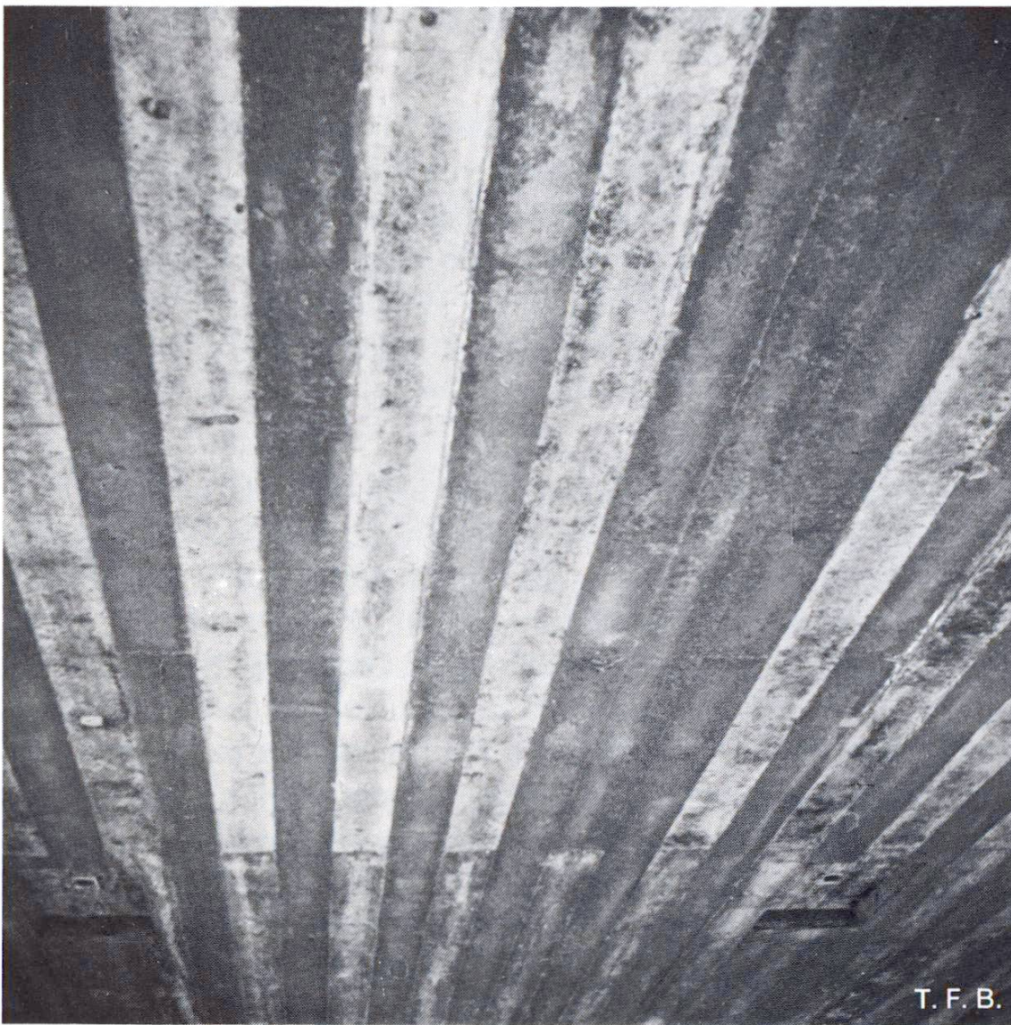
Fig. 6 Un retrait inégal des différentes planches de coffrage provoque de fortes irrégularités de la teinte du béton.
