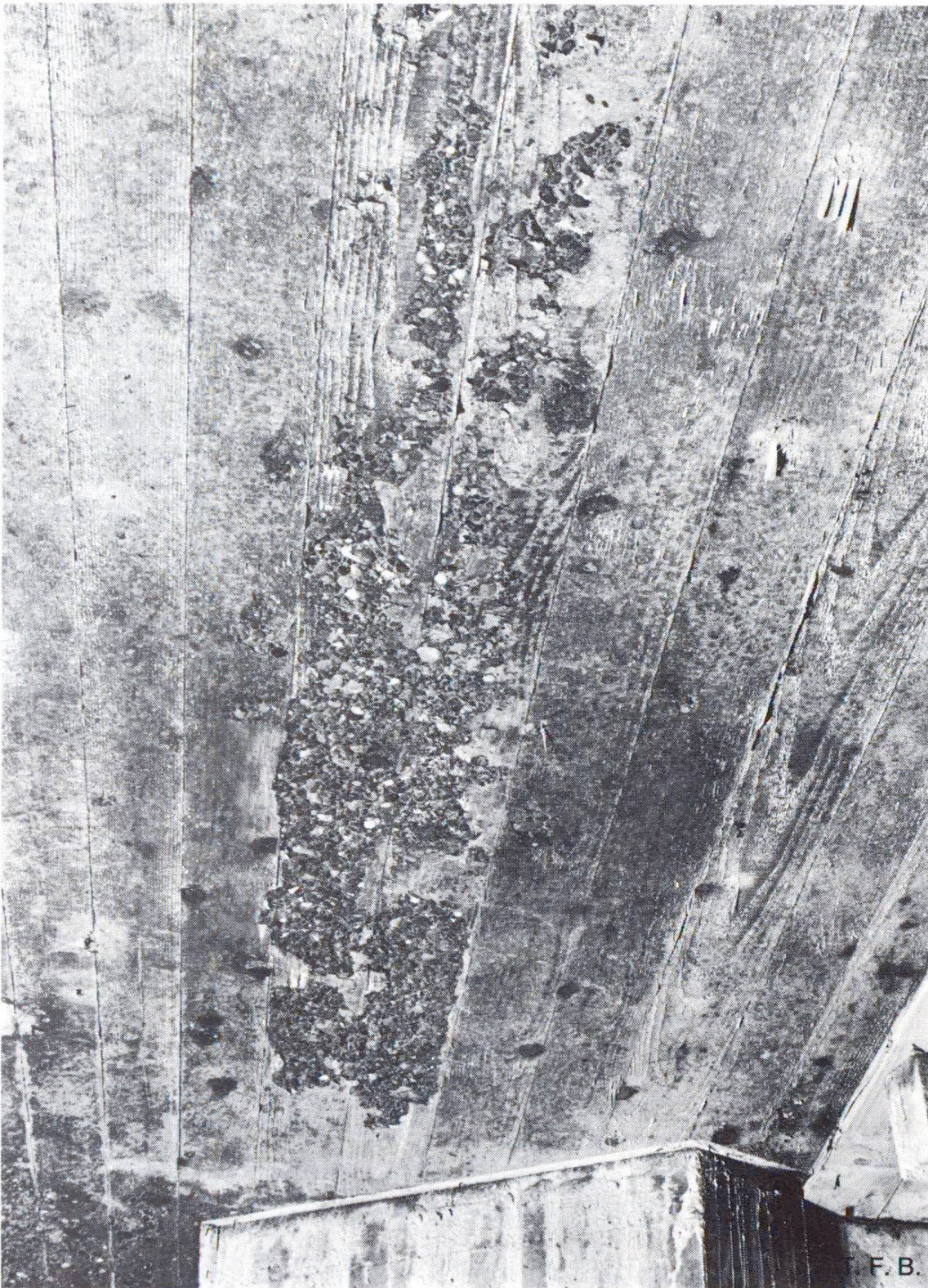
Fig. 5 Des flaques d'eau ayant localement liquéfié le béton et provoqué une ségrégation supplémentaire, le mortier a été affaibli au voisinage du coffrage et n'a plus enrobé correctement les granulats.
