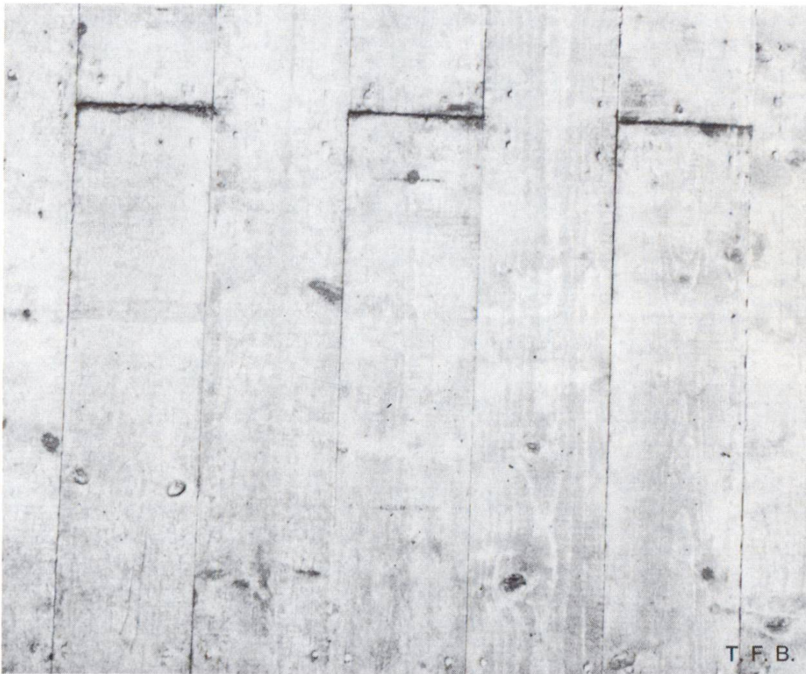
Fig. 3 Béton obtenu au moyen d'un coffrage en panneaux de planches rabotées. Les panneaux sont constitués de planches clouées avec joints à rainure et languette.
