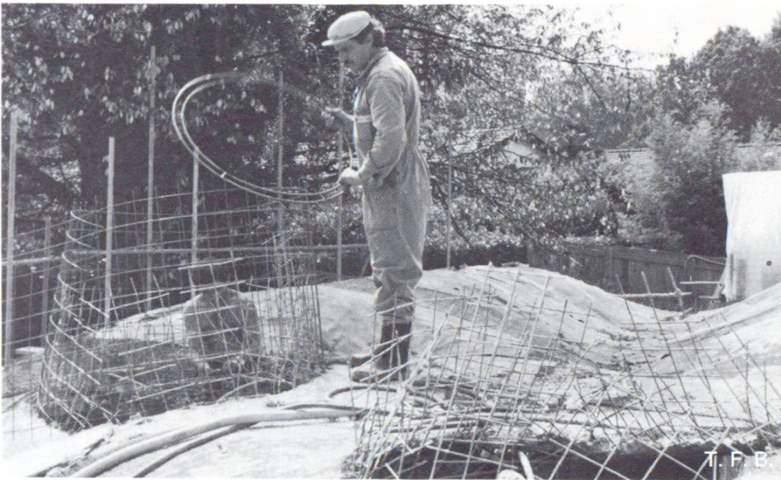
Fig. 6 Raccordement aux coupôles transparentes. La première couche de béton a été brisée et on met en place l'armature du «cratère» avec un anneau métallique sur lequel viendra se fixer la coupole. Ensuite, les autres couches de béton pourront être projetées.
