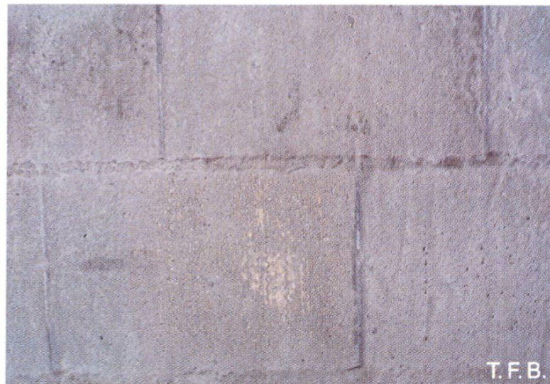
Fig. 10 Cette couche d'accrochage au ciment est comme vitrifiée. La fine couche de mortier au sable fin gachée avec trop d'eau a «eu soif» sur les briques en terre cuite très poreuses. Elle n'a pas pu durcir complètement.
