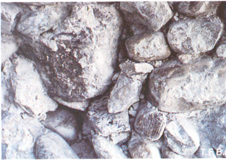
Fig. 7 Le rhabillage de cette maçonnerie mise à nu requiert une grande habileté et beaucoup de soins de la part du maçon (Château de Laupen, partie sud, 1986).
