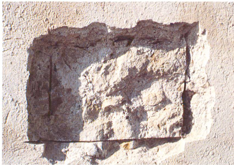
Fig. 9 Après la rénovation, le crépi s'est détaché en plusieurs endroits. Seules quelques traces de mortier ont adhéré à la surface des pierres. Supposition: Couche d'accrochage absente ou pas assez solide et couche projetée trop épaisse.
