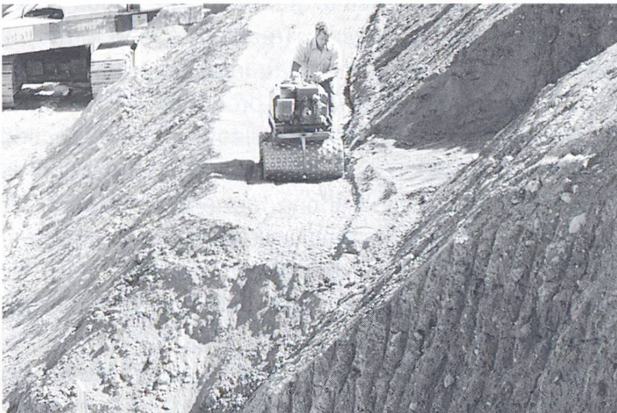
Fig. 16 Pour les berges escarpées, les couches sont mises en place horizontalement (travaux exécutés avec des bermes comme dans les grands chantiers)
