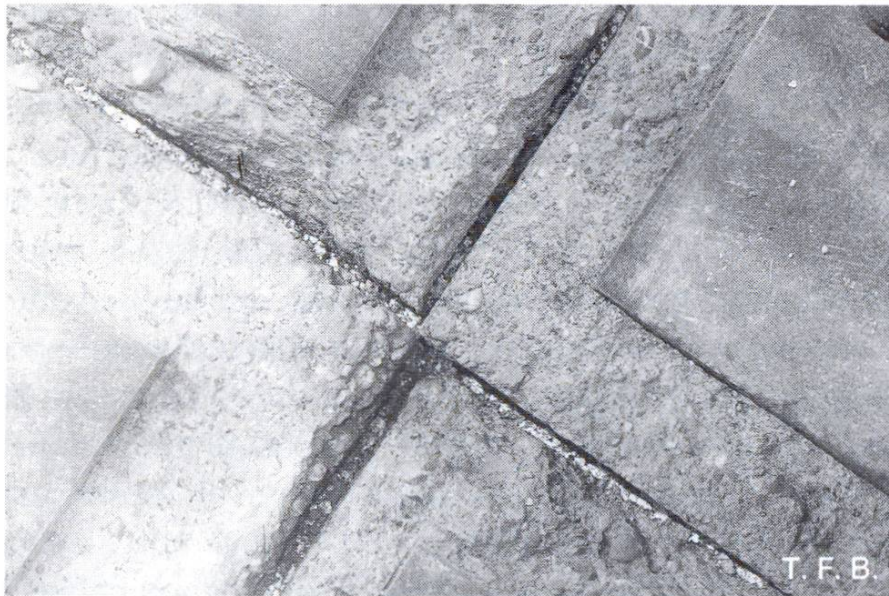
Fig. 7 Le doublage de joints souvent utilisé, composé de 10 mm et plus de produit mousse, est en l'occurrence inadéquat. De plus, les joints ne sont pas rectilignes. Dans la zone des arêtes, le béton dur a éclaté et il a fallu le remplacer. Conclusion: il faut exécuter soigneusement le coffrage latéral et utiliser des bandes couvre-joints de moins de 6 mm d'épaisseur.
