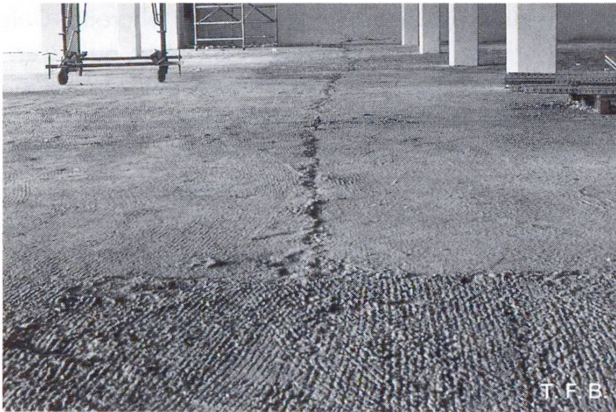
Fig. 6 Exemple d'un mauvais joint de reprise dans la dalle de fond flottante. Il est trop large, pas rectiligne, et a de mauvaises arêtes. Un béton dur ne pourra pas résister aux sollicitations prévues dans cette zone.
