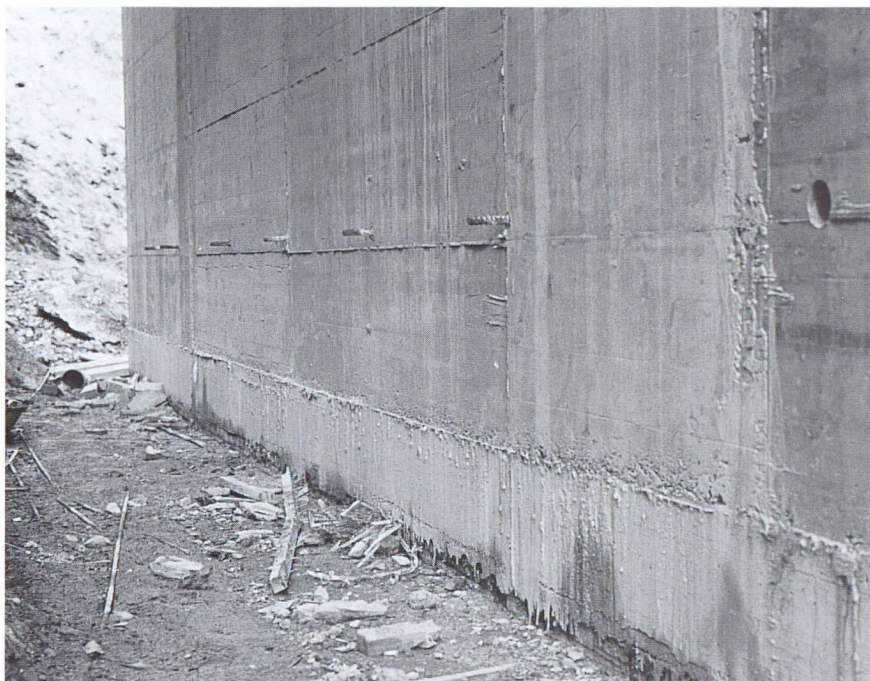
Partie de mur en béton lourd (à l'arrière) et béton ordinaire (bloc de radio-protection pour deux accélérateurs linéaires à l'hôpital cantonal de Lucerne).
