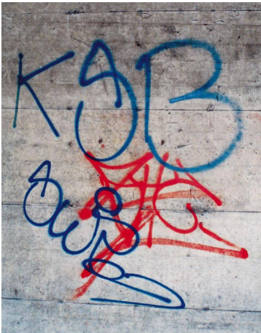
Des «souillures du béton» d'un genre particulier: les graffiti.
