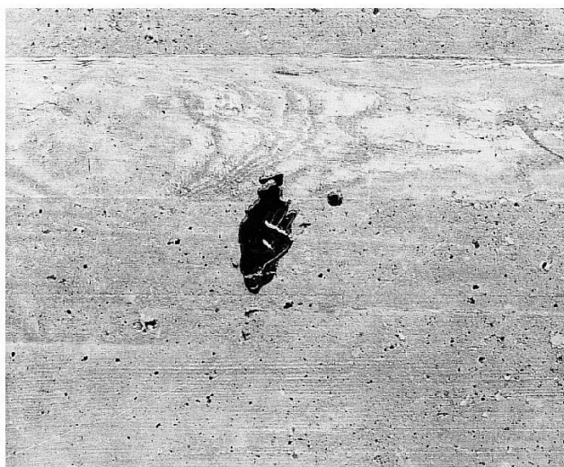
Fig. 1 Surface de béton souillée par du bitume.
