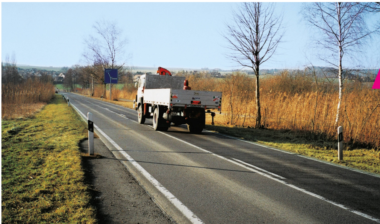
Route cantonale Oberhöri-Dielsdorf (Neeracher Riedt). Cette route construite en 1951 traverse la zone marécageuse. Elle se relève et s'abaisse de 1 à 4 cm par année, en fonction de la nappe souterraine; niveau de la nappe souterraine: bord inférieur du revêtement en béton!
