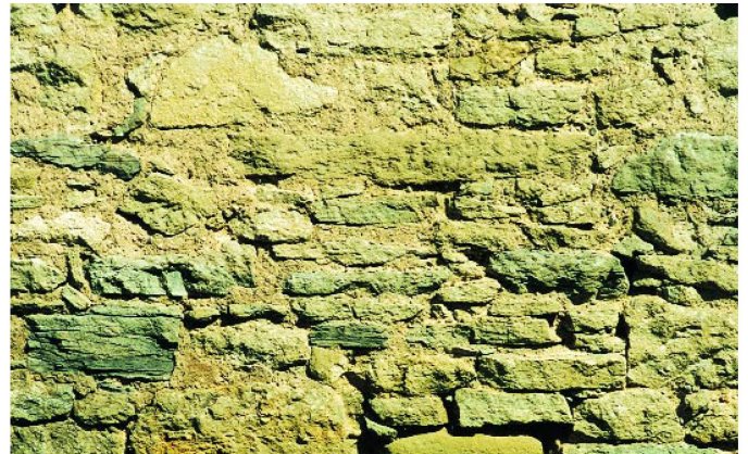
L'ancienne maçonnerie apparaît derrière l'enduit qui se détache: mur de maison à Lenzbourg. Photos: Kurt Hermann
