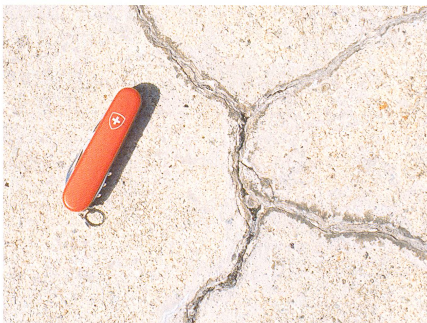
Fig. 6 Dégâts dus à la RAG sur le couronnement d'un barrage. Les fissures contiennent du gel de silice (foncé).
