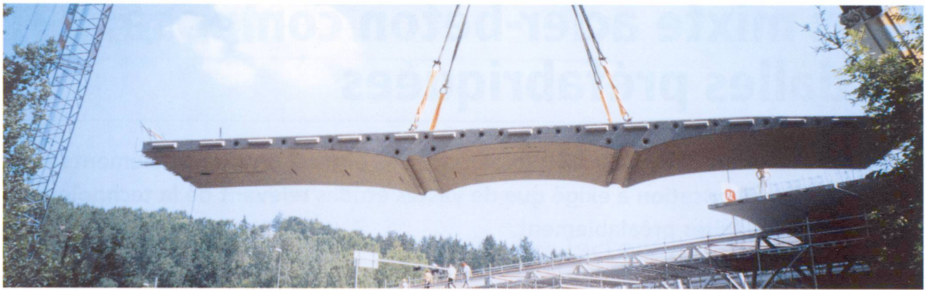
Fig. 2 Une des 61 dalles préfabriquées du nouveau viaduc de la A1 à Dättwil est mise en place au moyen de la plus grande autogreue sur chenilles de Suisse. Ces dalles ont 15,90 m de longueur, 3,20 m de largeur, et aux endroits les plus minces, 0,25 m d'épaisseur.
