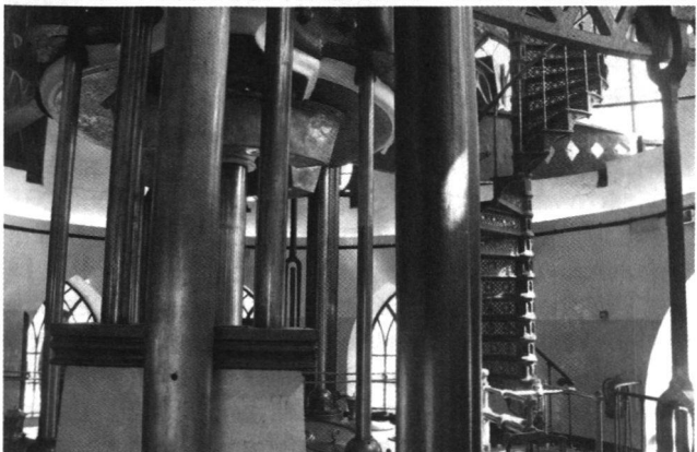
Abb. 7: Pumpwerk Cruquius (Bild P. Heitzmann)
