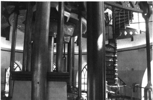
Abb. 7: Pumpwerk Cruquius (Bild P. Heitzmann)
