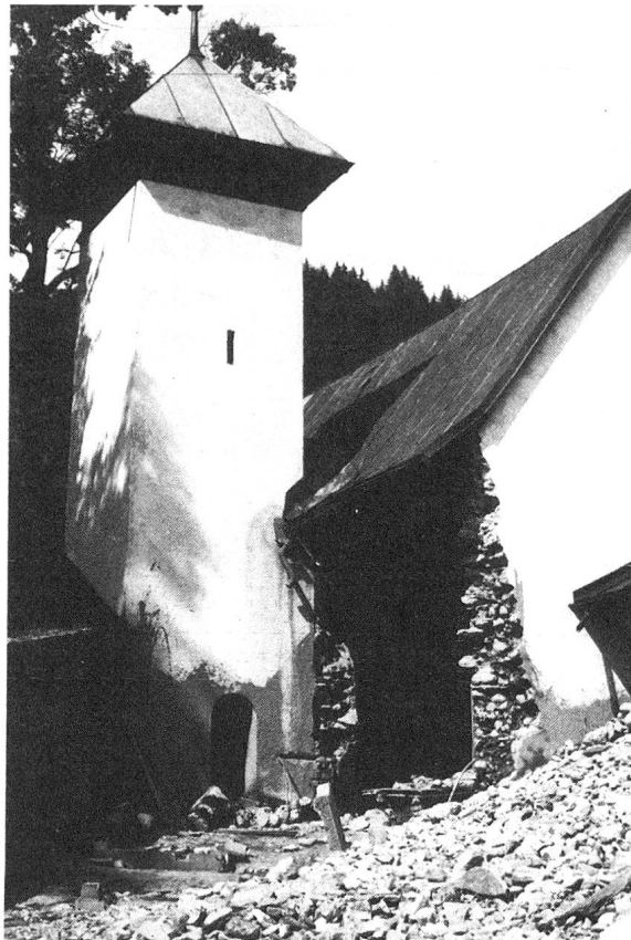
Die Schuttmassen drangen in die Kirche ein, verwüsteten das Innere und rissen eine Seitenwand heraus.
