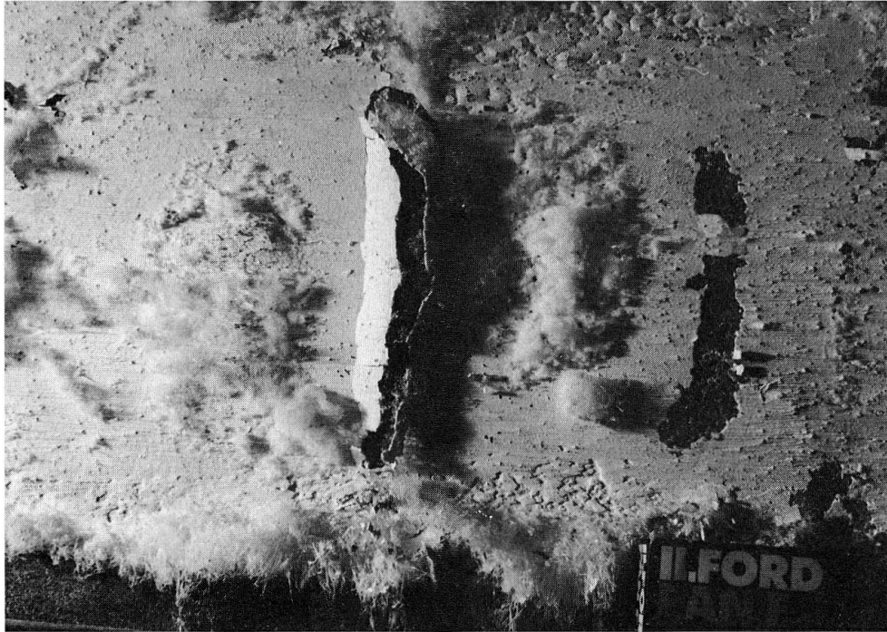
Abb. 8: Chur, Kapelle St. Stephan: Ostwand, Salz- absprengung an einer Kupfer- rinne.
