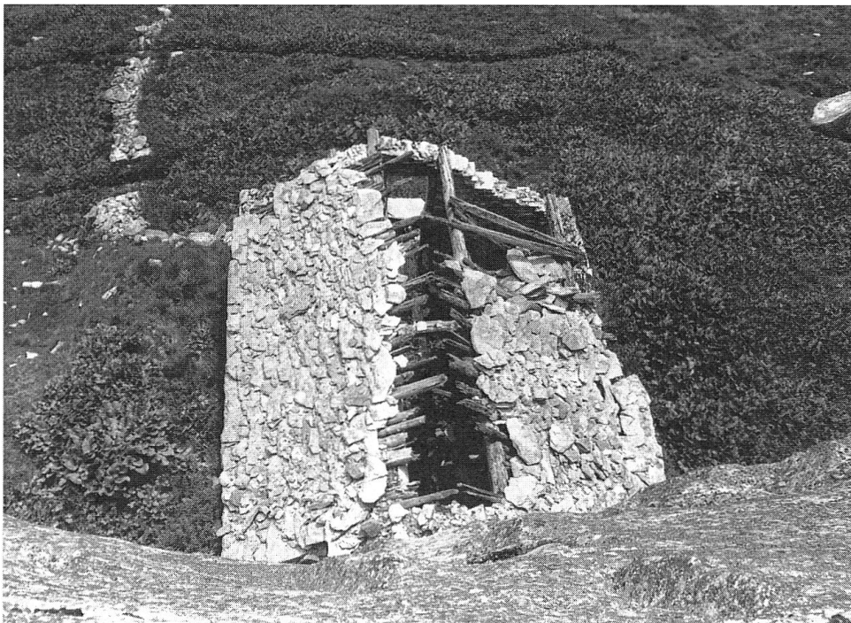
Abb. 9: Stark beschädigtes Dach eines «Stalles»; Etzmeder
