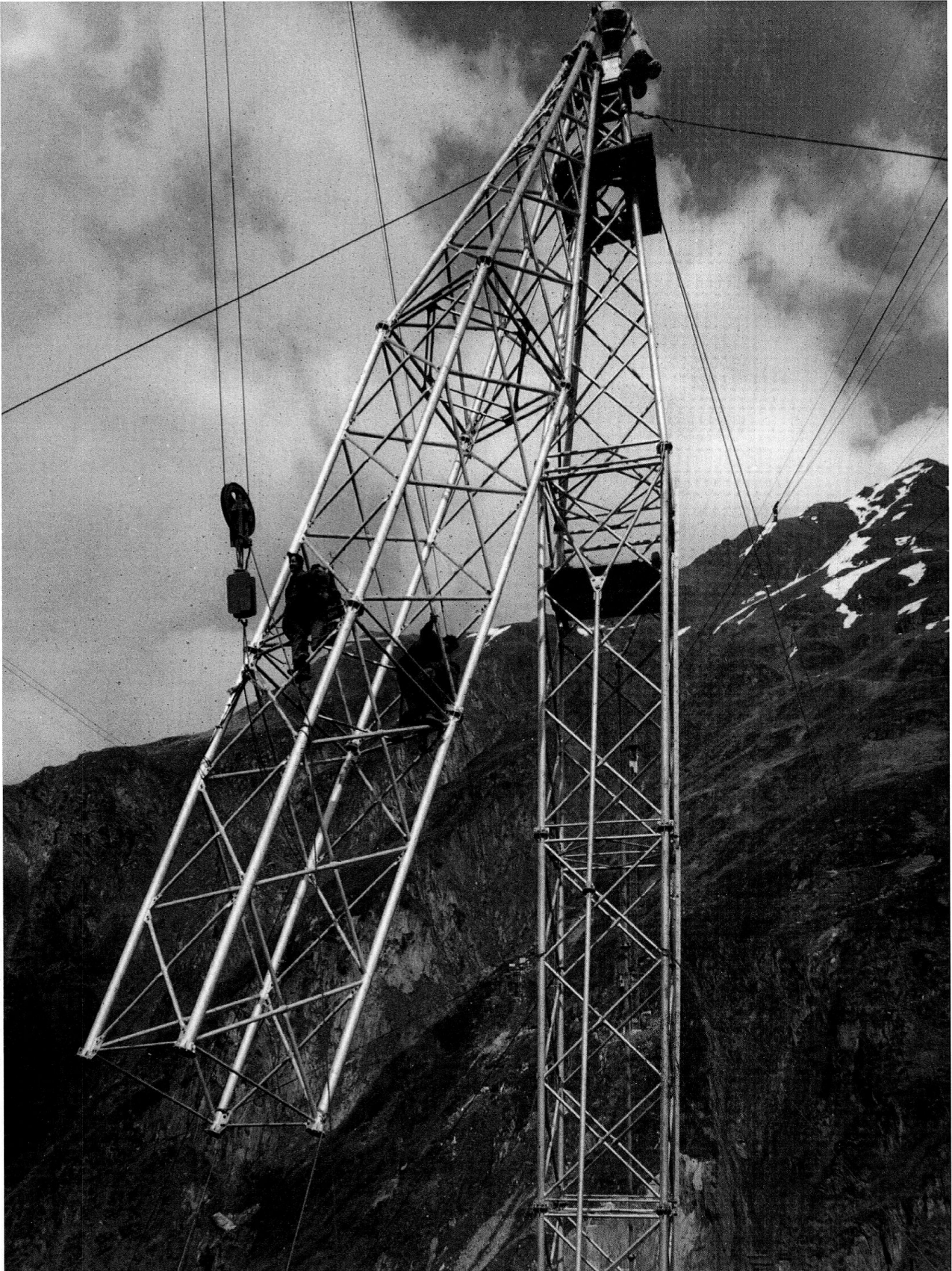
Baustelle Curnera, 5.6.1964: Detail der Montage der einen seitlichen Verstrebung am vertikalen Pylon des Derricks.
