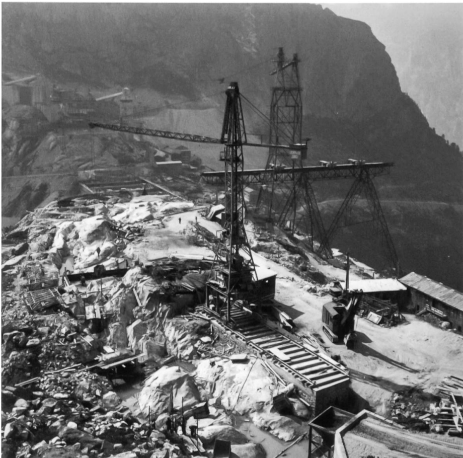
Die Krananlage steht auf der Seite des Piz Balzet (Foto: Urs Beyeler, Bern).
