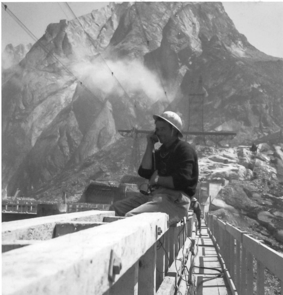
Telefonist auf der Staumauer Er ist mit den drei Kranführern verbunden und dirigiert die Betonbehälter an den richtigen Platz (Foto: Urs Beyeler, Bern).
