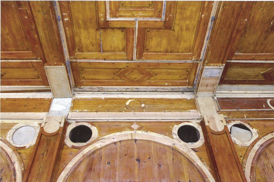
Profile abgeschlagen: das durch die Purifizierungs-Altion von 1963 versehrte Täfer der Wandelhalle (Foto: Denkmalpflege Graubünden).
