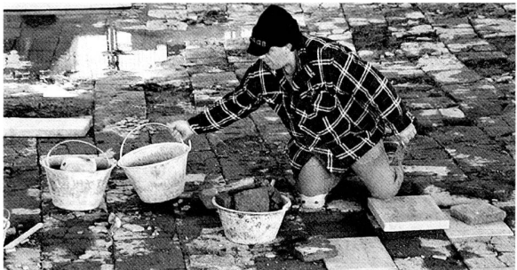
Fig. 6. Réparation du dallage. Pour conserver la position originale de chacun d'eux, c'est dalle par dalle qu'on prélève les éléments dégradés et qu'on pose les nouveaux sur un lit de gravier très fin. Photo MRA.
