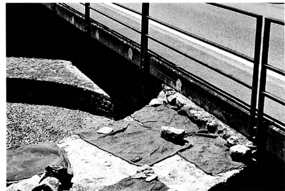
Fig. 12. Les travaux au mortier de chaux se font durant la belle saison. Pour éviter une dessiccation trop rapide par le soleil ou le vent, le mortier frais est protégé par des toiles de jute régulièrement arrosées. Photo MRA.
