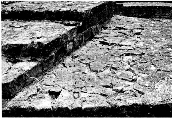
Fig. 9. Détail d'une chape de mur dégradée. Photo MRA.
