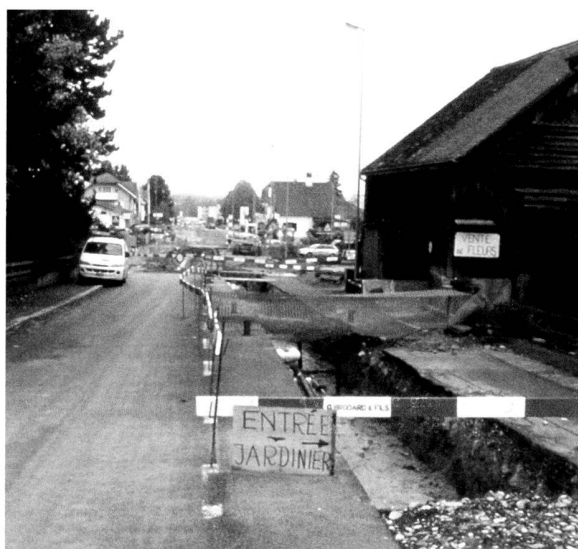
Fig. 12. Avenches/Avenue Jomini. L'avenue Jomini en chantier au début de l'automne 2004. L'ouverture des tranchées pour les conduites du chauffage à distance et du réseau d'eau communal a parfois posé des problèmes d'accès aux habitations riveraines.
