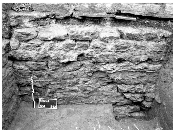
Fig. 33. Avenches/En Selley, théâtre. Sondage S 62. Joint de reprise en sous-œuvre du mur M 66.
