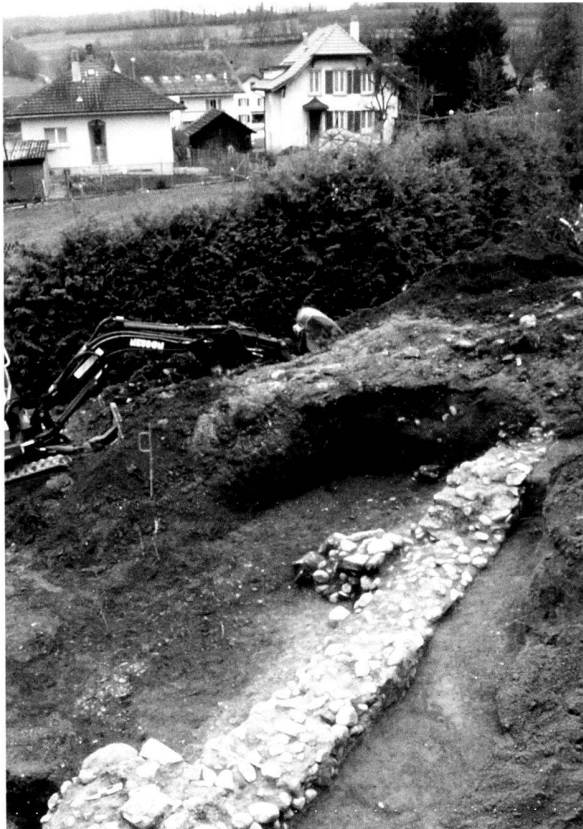
Fig. 14. Avenches/Chemin de Derrière la Tour 1. Le mur de soutènement de la terrasse. Vue du nord-ouest.
