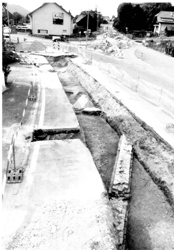
Fig. 25. Avenches/Insula 19. Vue générale de la partie ouest de la tranchée ouverte en bordure de la route de Berne. Au second et dernier plan, les murs délimitant la galerie sud du complexe thermal.
