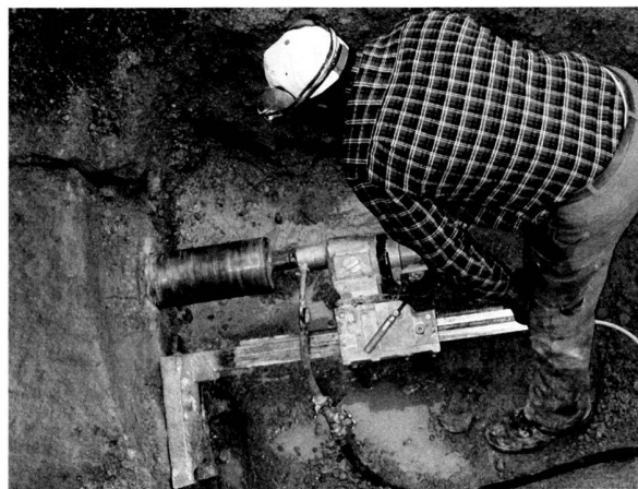
Fig. 7. Installation d'un drainage au travers du mur périmétral de l'amphithéâtre. Photo MRA.
