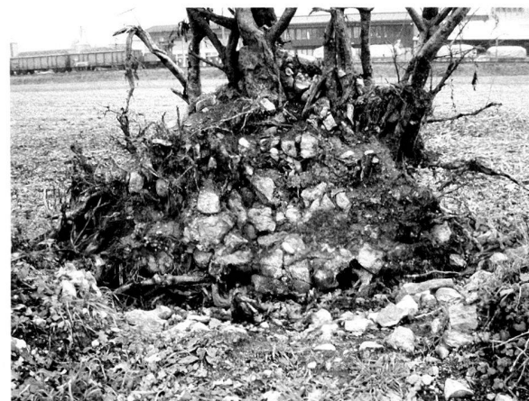
Fig. 5. Le Mur d'enceinte Vers la Gare, endommagé par la chute d'un arbre enraciné sur sa maçonnerie. Photo MRA.
