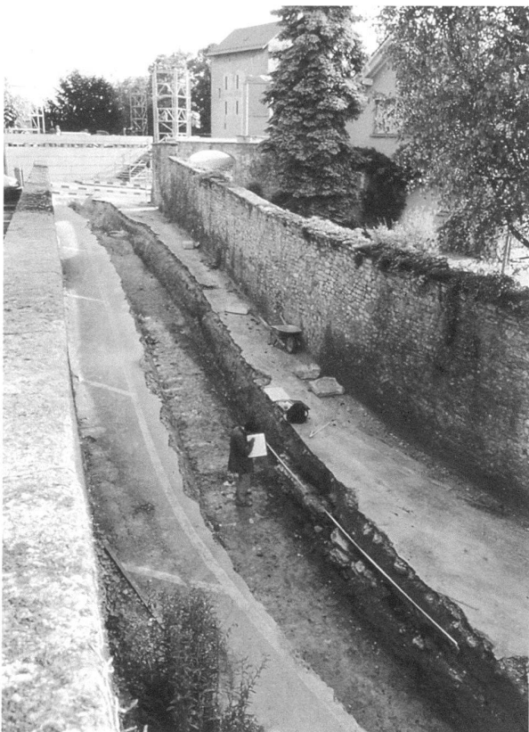
Fig. 24. Avenches/Route de la Grande Poya. Vue des travaux dans la partie amont de la rue.
