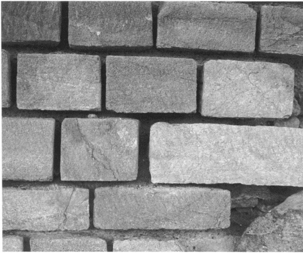
Fig. 8a. Mur d'enceinte. Détail du parement côté campagne avant restauration (photo MRA).
