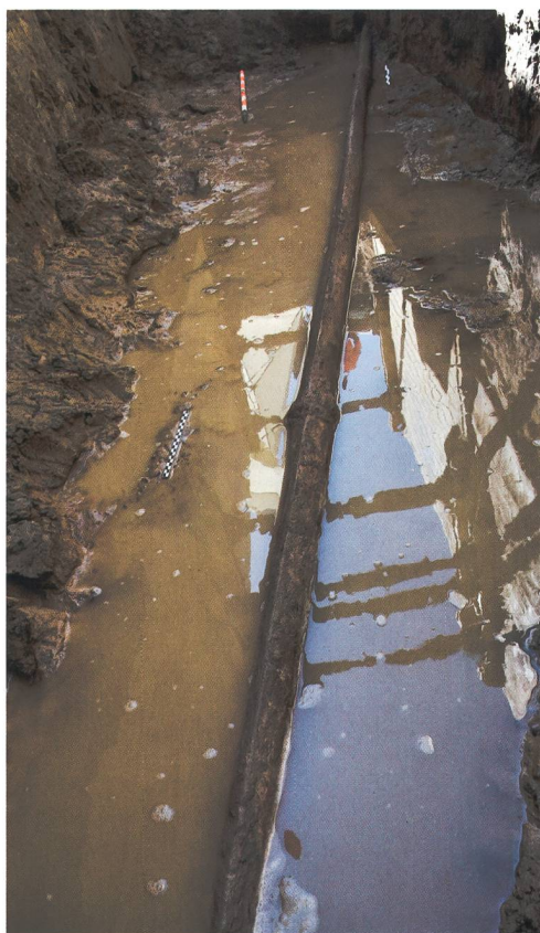
Fig. 13 (à gauche) 2018.01. Route de contournement RC 601 Est. Situation de la conduite en plomb au moment de sa découverte.
