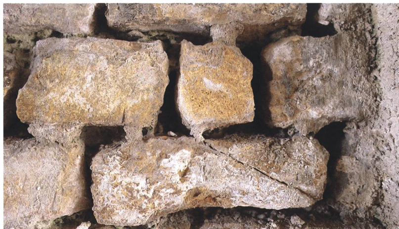
Abb. 23 (unten) Amphitheater, Gewölbezugänge im Osten. Aufgelöster Mörtel im originalen Kalksteinmauerwerk des zentralen Gewölbezugangs.
