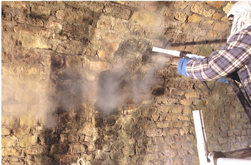
Abb. 21 (oben links) Amphitheater, Gewölbezugänge im Osten. Mit dem CO 2 /Trockeneisverfahren lassen sich Verschmutzungen und Algen auf der Unterseite der Tuffsteingewölbe schonend und effizient entfernen.
