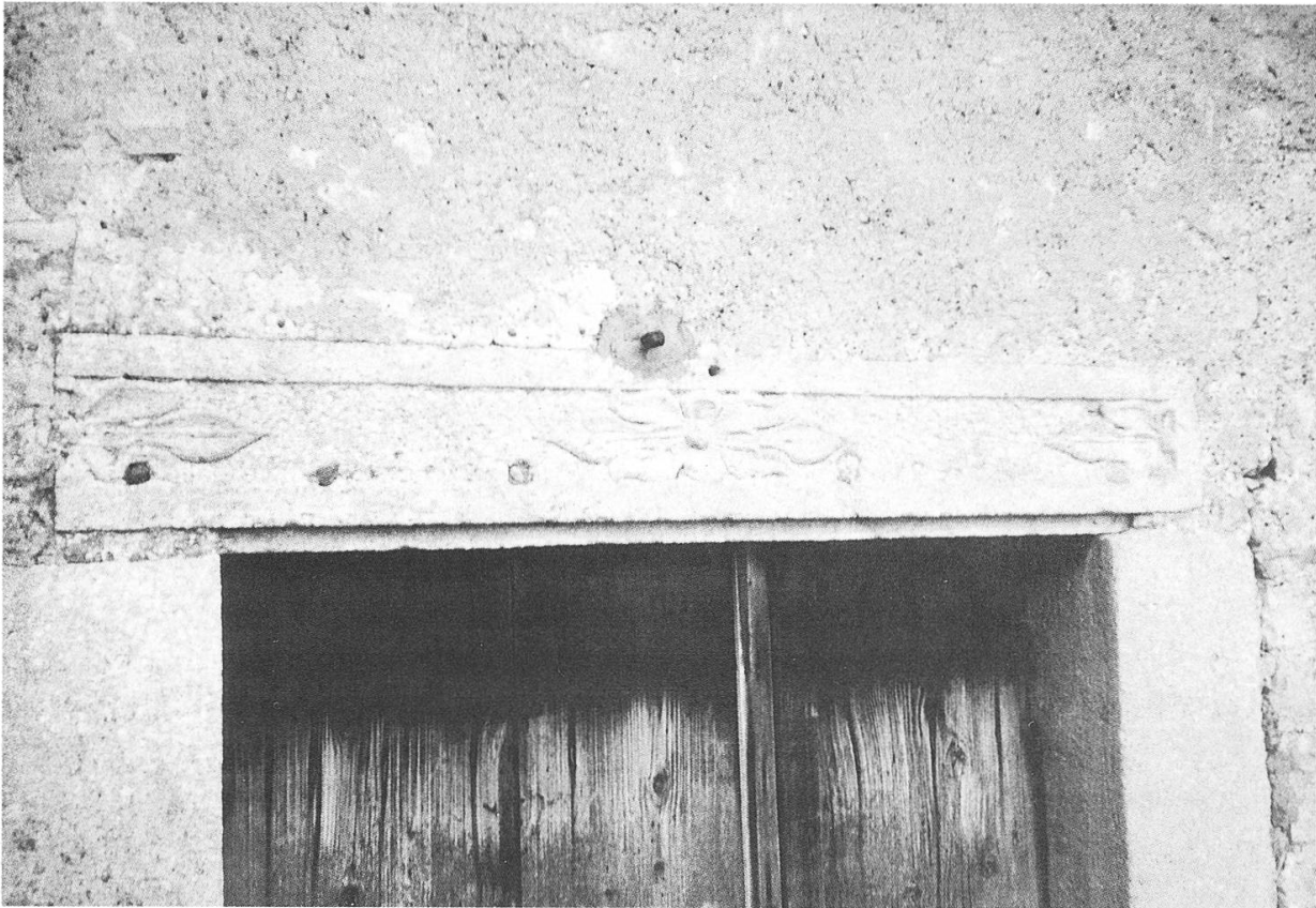
Abb. 6: Schinznach Dorf, Steinsturz im Hause Känzig, neben dem Doktor-Haus.
