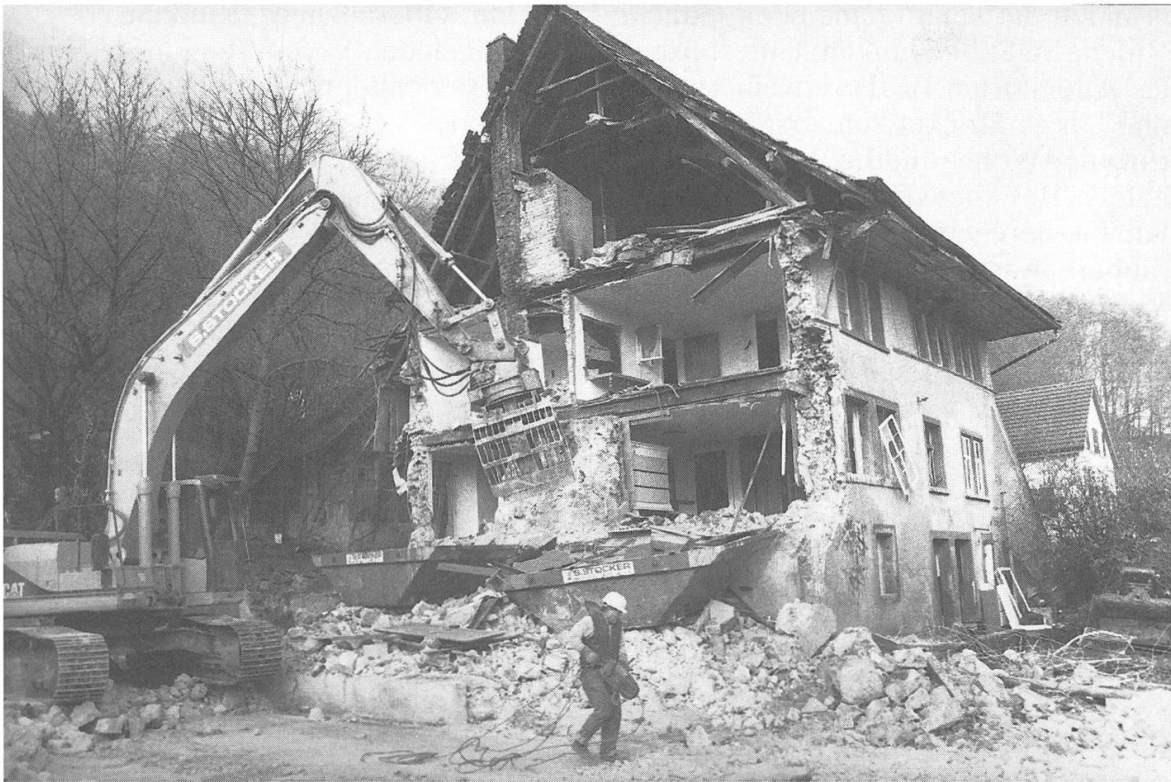
DEZEMBER 1995 – Mit dem Abbruch der einsturzgefährdeten alten Mühle an der Hohlgasse in Lauffohr verschwindet ein markantes Bauobjekt. Foto: Geri Hirt, Badener Tagblatt
