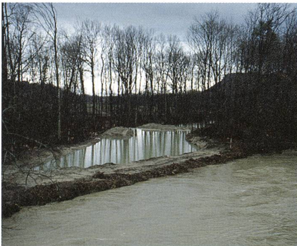
Das Hochwasser vom Februar 1999 füllt die Baugrube.
