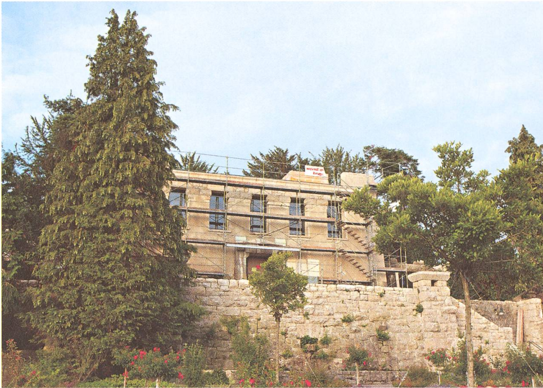
An der Scheinzypresse sind zwei Wipfel sichtbar; der linke ist vom zentralen Stamm, der rechte stammt von der zweiten Stammgeneration. Die Scheinzypresse während der Renovationsarbeiten, als sie noch stand.
