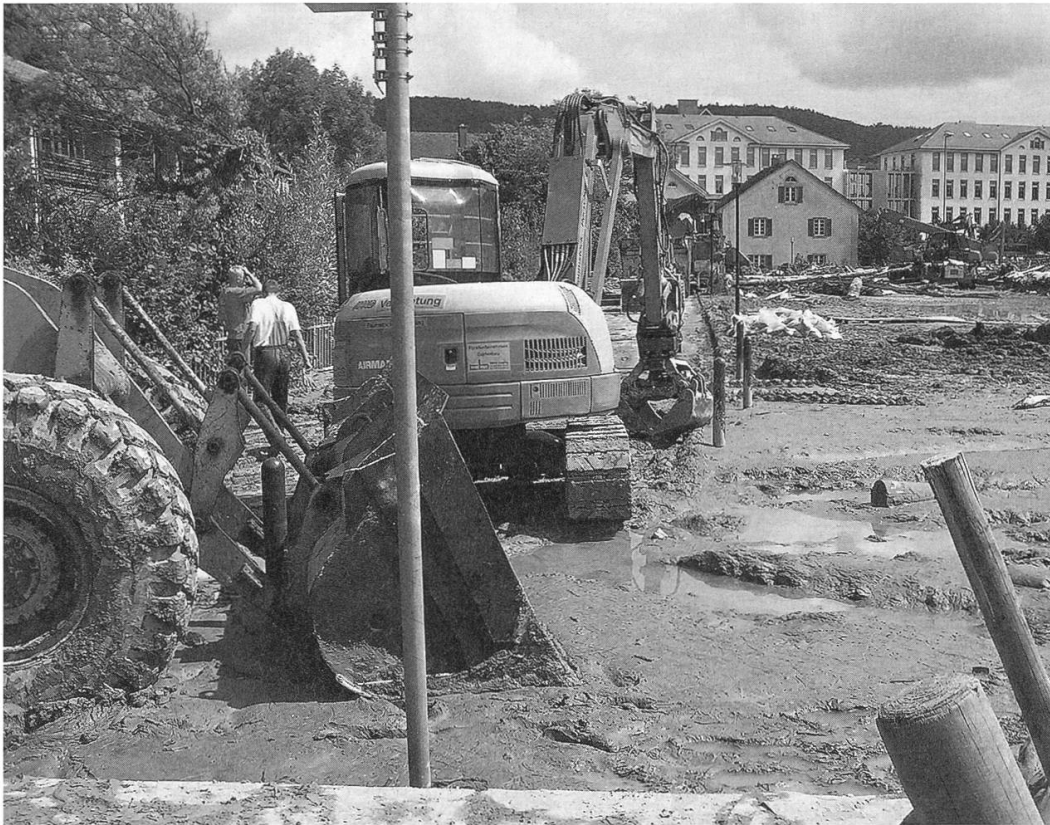
August 2005 – Das grosse Aufräumen von Schlamm und Geschwemmsel auf der Ländestrasse. Foto: CD Hochwasser Windisch 2005
