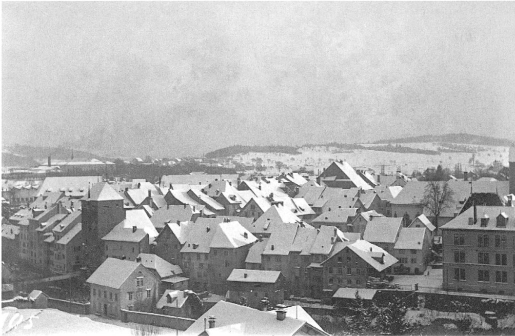
Diese Schneedecke legte sich schützend auf die Dächer und verbirgt allfällige Schäden von fehlenden Ziegeln, die der Sturm weggeweht hatte.
