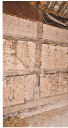
Abbildung 7. Flechtwerkwand der im mittleren 19. Jahrhundert westseitig angebauten Tenne. Foto: Theo Frey, Kantonsarchäologie Aargau
