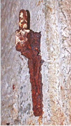
Verrostete Türangeln zeugen von einstigen massiven Toren, auch zwischen den beiden Kellern.
