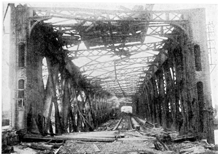
Fig. 1. Vue d'enfilade du pont d'Oissel après sa destruction.
