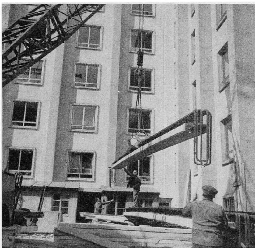
Fig. 4 - Complexe Administratif, rue de Louvain à Bruxelles . Poutres Preflex de 13,50 m avec aux extrémités des barres d'armature soudées à la poutrelle et servant à l'encastrement des poutres Préflex dans les colonnes.
