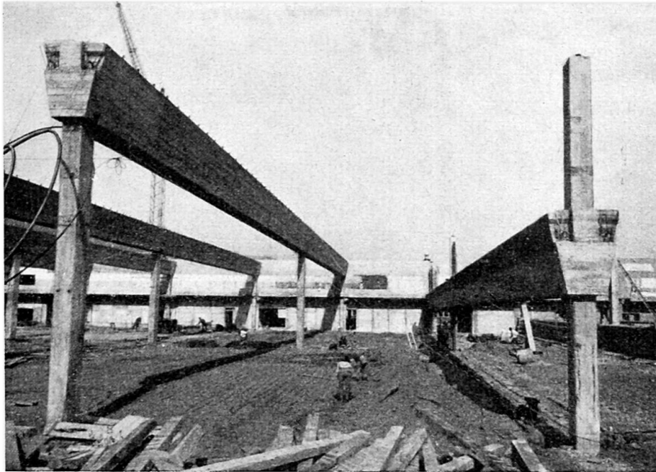
Abb. 5 - Am Boden vorgefertigte Träger von mehreren 100 to Gesamtgewicht werden mittels simultan arbeitenden hydraulischen Pressen auf provisorische Stahlstützen gehoben. Ingenieur: E. Wälli, Rorschach. Hebesystem: Hebag AG für rationelles Bauen, Tübach SG.
