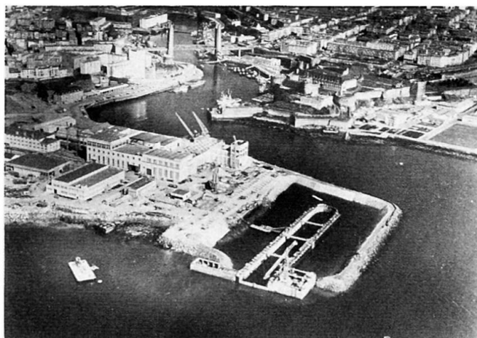
Finition de la digue d'enclôture du terre-plein après échouage du bassin et adjonction d'un caisson de quai.
