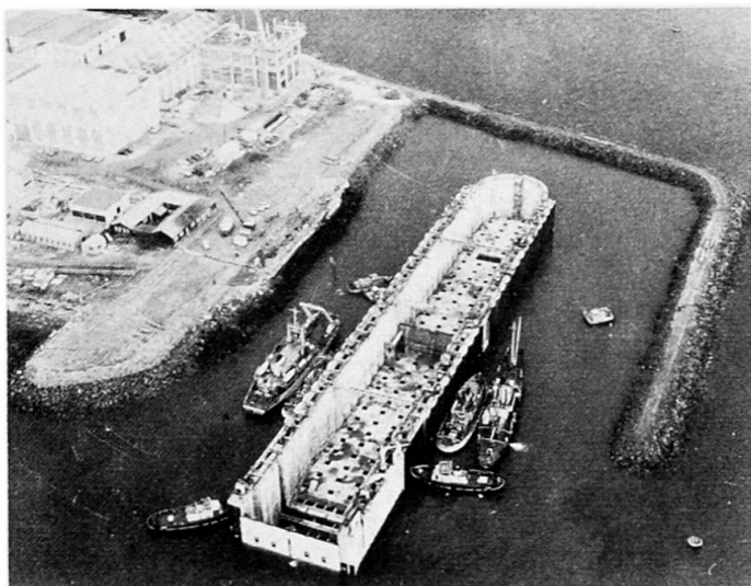
Amenée du corps de bassin sur le site d'échouage, avant clavage de la station de pompage latérale (déplacement 35.000 t.)
