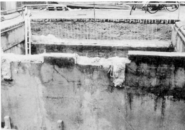
Bild 1: Salzlösegrube nach dem Abstemmen der Abdeckplatten
