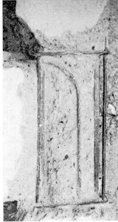
Fig. 36. Etat de la colonne métallique d'un nœud enrobé après la mise hors service.
